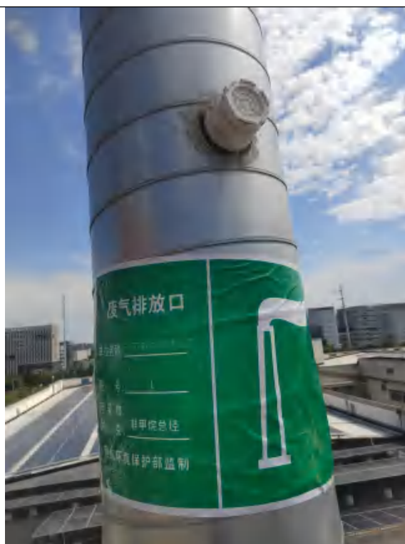
二级活性炭处理设施排气筒标识牌
