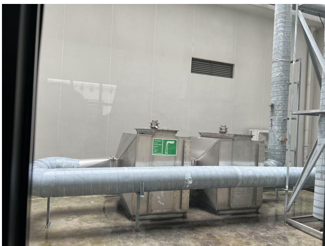
二级活性炭处理设施活性炭箱
