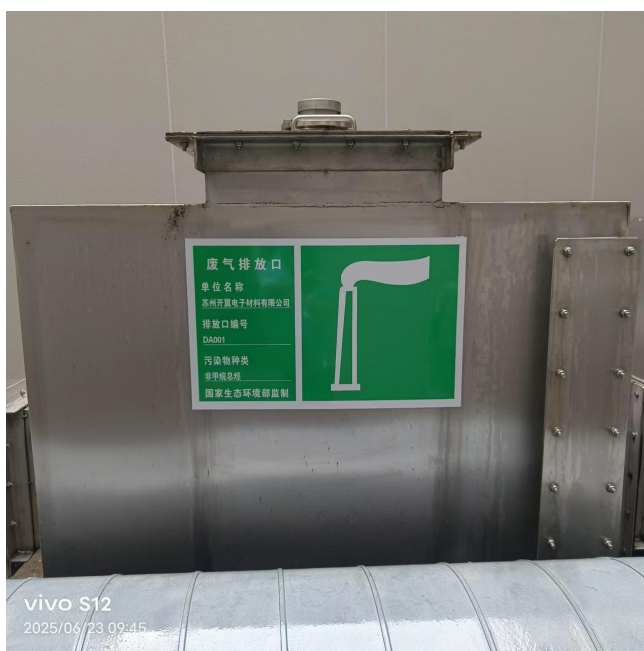
二级活性炭处理设施排气筒标识牌
